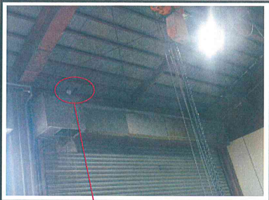
工場内 シャッターBOX上部にハト停鳥
